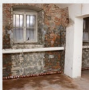
bei feuchtem Mauerwerk
